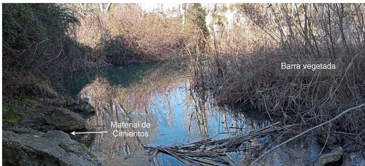
Figura 43. Materiales desprendidos de infraestructuras e invasión vegetal del cauce en tramo de Zuera. Fotografía de la autora (3/02/23).
